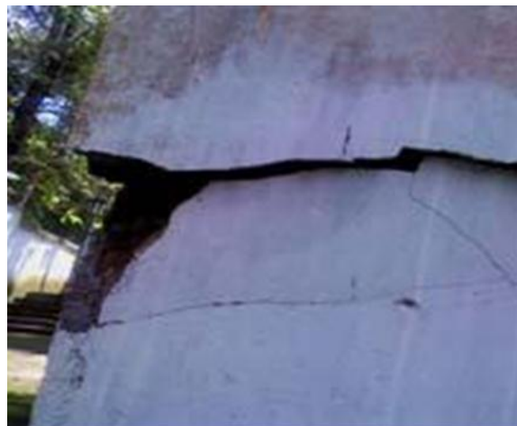
Gambar 2: Bangunan rusak ringan.
