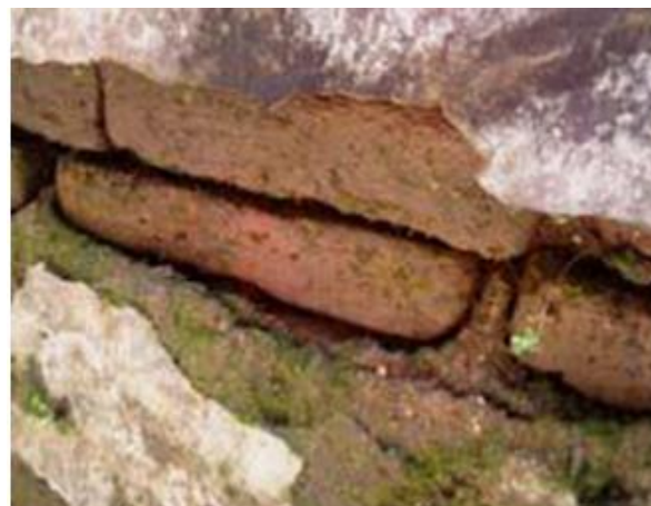
Gambar 4: Benteng gapura yang rusak
