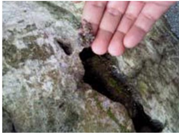
Gambar 1: Pengecekan kerusakan dinding bangunan makam.
